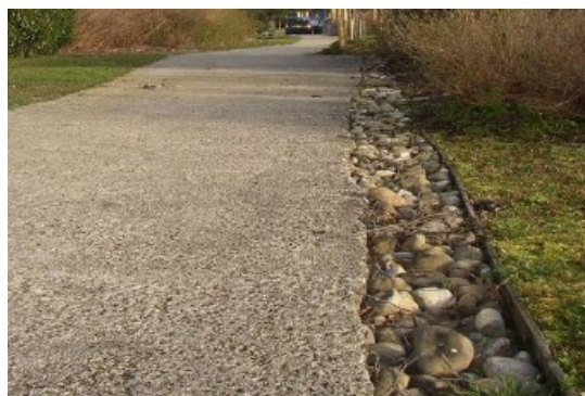
Petite tranchée drainante le long d'un espace piétonnier (Source : Grand Lyon)
